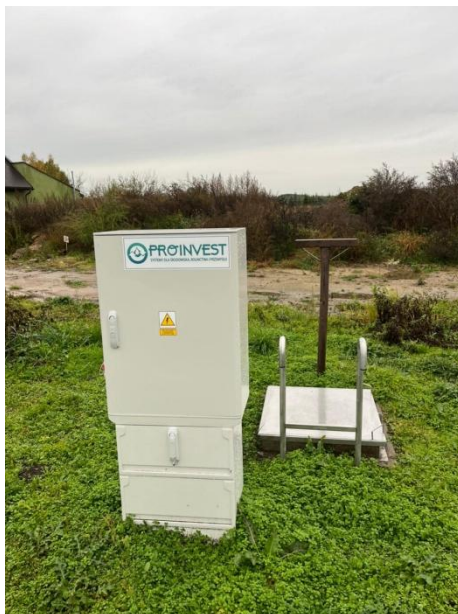
Jedna z przepompowni ścieków w m. Koza Wielka
