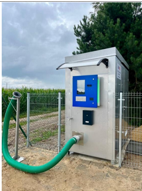
Stacja zlewna przy Oczyszczalni Ścieków w Perzowie
